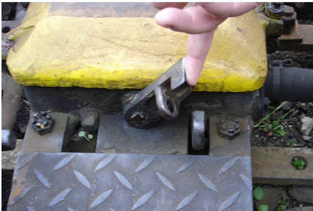
Elektrický výměnový zámek – po otočení závorovací páčky lze výhybku ručně přestavovat
