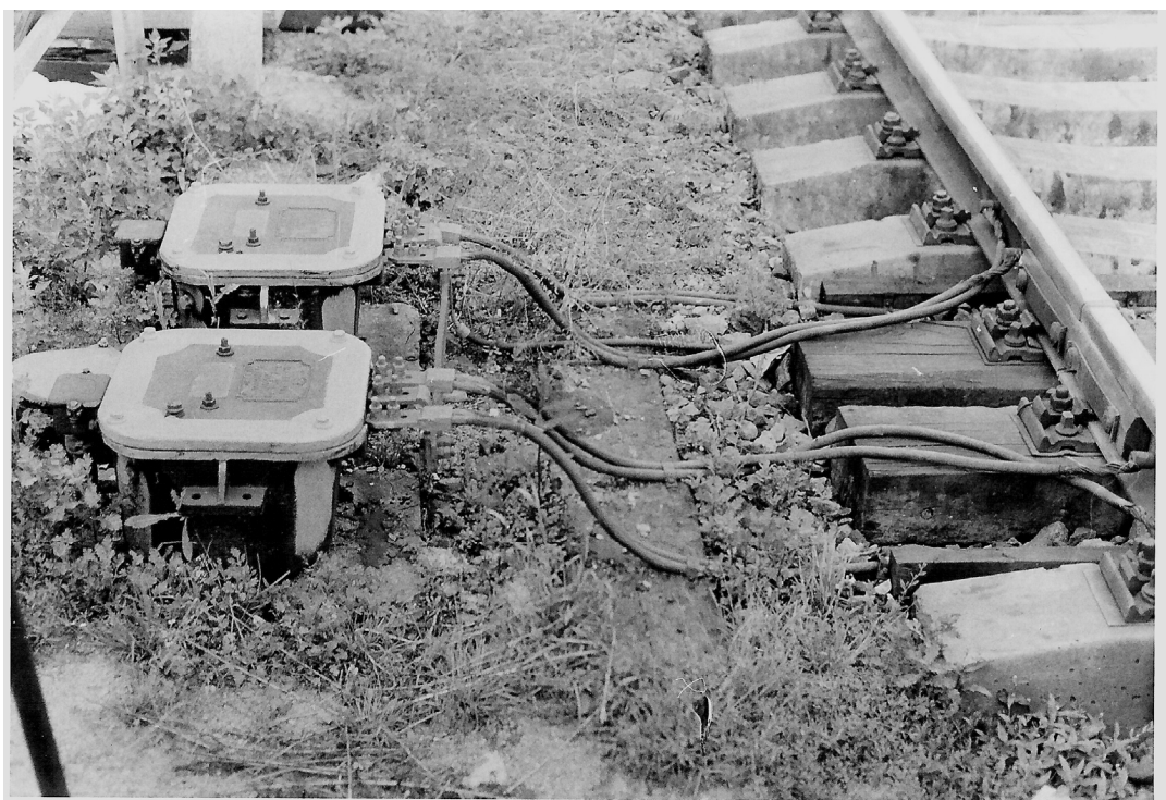
Izolovaný styk kolejového obvodu
