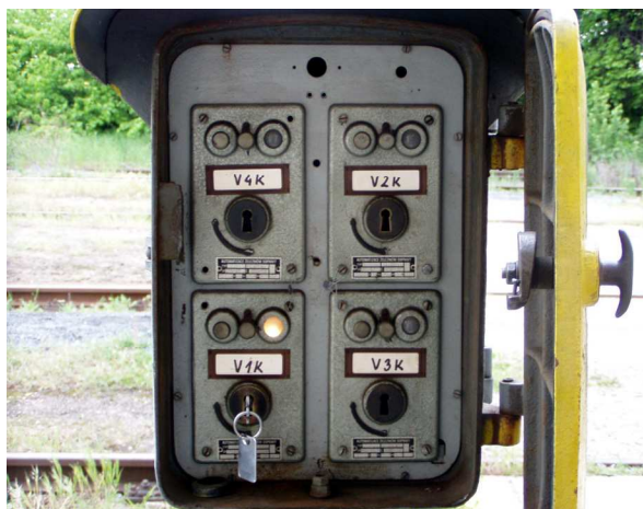
Stav vnějšího EMZ po potvrzení přítomnosti v kolejišti pro 1.kolej
