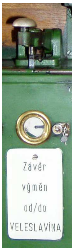
Výměnové hradlo s nouzovým vybavovacím zařízením
